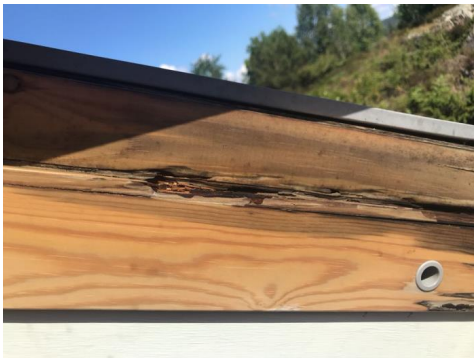
Bilde viser takvindu med råte.
